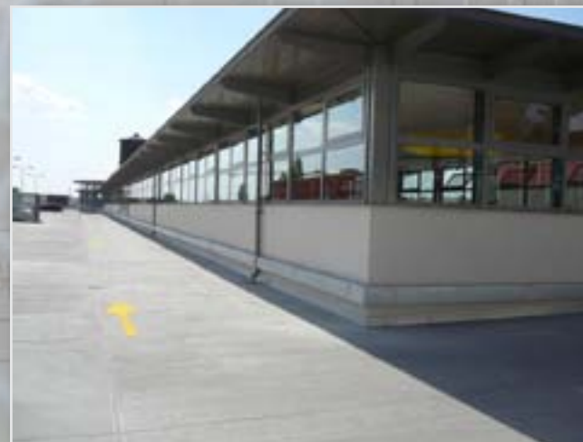
Ütközésvédő acél profilok a tetőn
