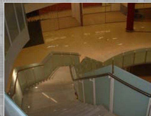
Rozsdamentes acél- és üvegkorlát
